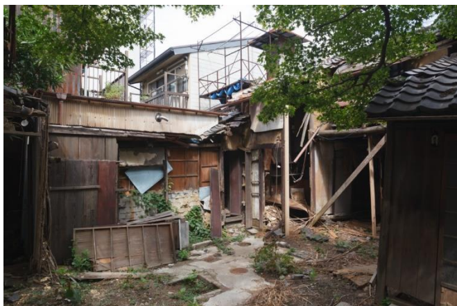
(施工前) 屋根が落ち危険な状態だった 築 100 年を越す 5 戸の京町家
